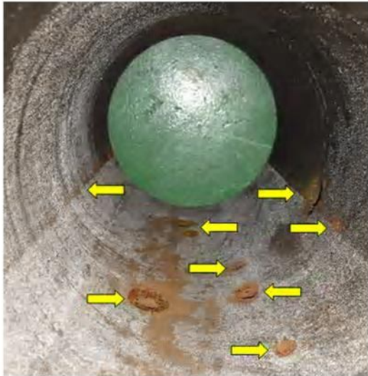
Gambar 1. Posisi Lubang dan Kerusakan
